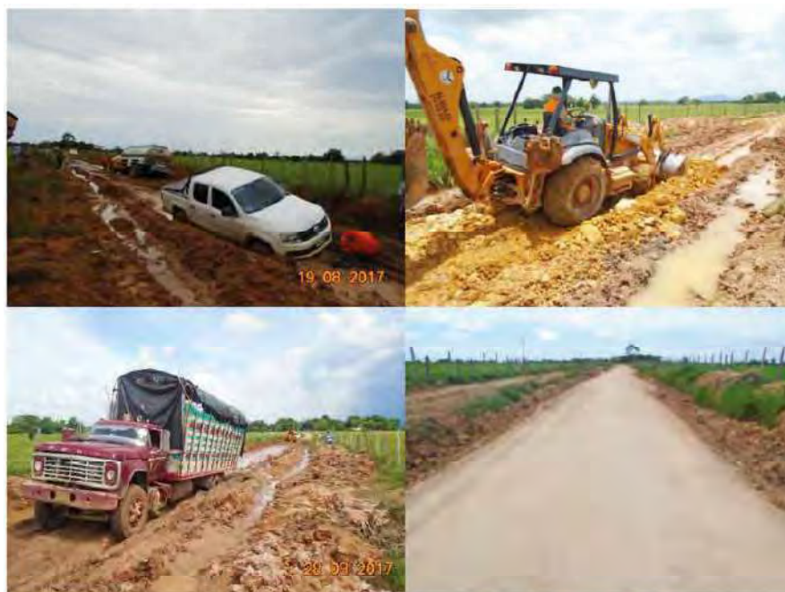
Figura 80. Ejemplo de pasos críticos en vías públicas con pobres especificaciones de construcción. Se observan situaciones de enterramiento de vehículos y trabajos de mantenimiento y mitigación vial desarrollados ocasionalmente por el contratista sísmico en conjunto con las instituciones locales. Se realizan actas de vecindad para documentar el proceso. Fotos archivo personal.
